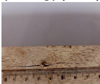
Gambar 25. Retak permukaan kayu akibat pemakuan paku kayu
